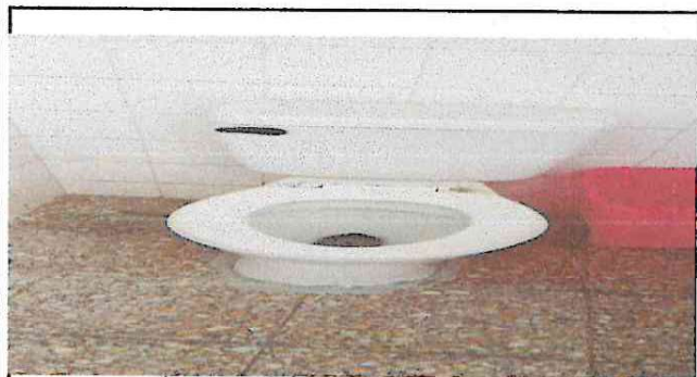
Foto 9: Lavamanos e inodoros en mal estado
