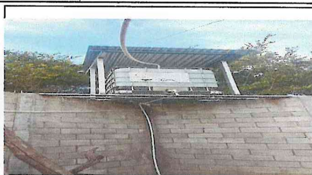
Foto 8: Tubería en mal estado y tapada
